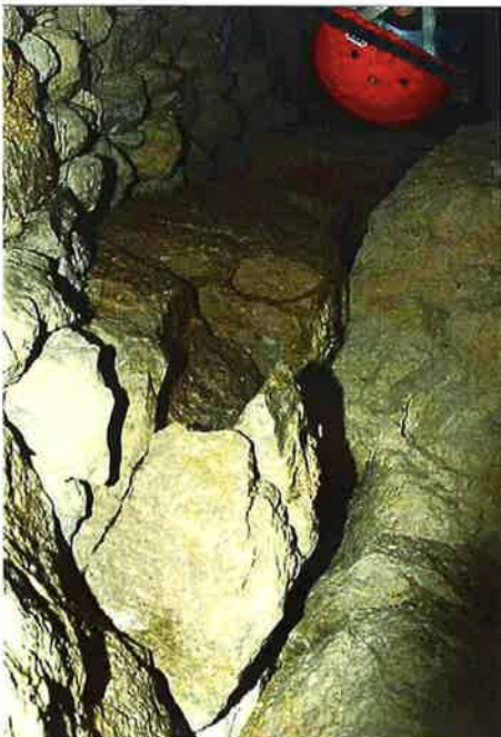
Figure 10 : Dégradation du ciel de carrière le long d'une diaclase ouverte
