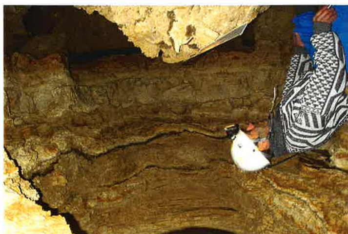
Figure 7 : Fontis sous la rue Pozzo di Borgo, avant complètement
